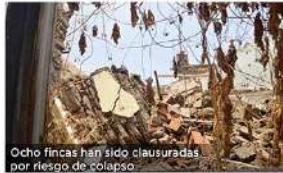
Ocho fincas han sido clausuradas por riesgo de colapso
